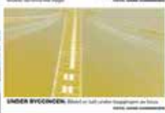
UNDER BYGGINGEN: Østfoldregionen er på vei mot Skjombrua. Her er det allerede bygd opp mye av konstruksjonen. Det er nå på vei opp på plass. (Foto: Østfoldregionen)
