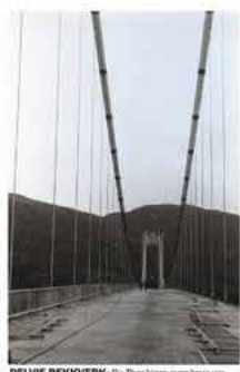
DELVIS REKKVERK: Da Thor kjørte over brua var ikke rekkverk montert – og det kan ha sett orientert slik ut. Men da han kjørte var det mørkt.
